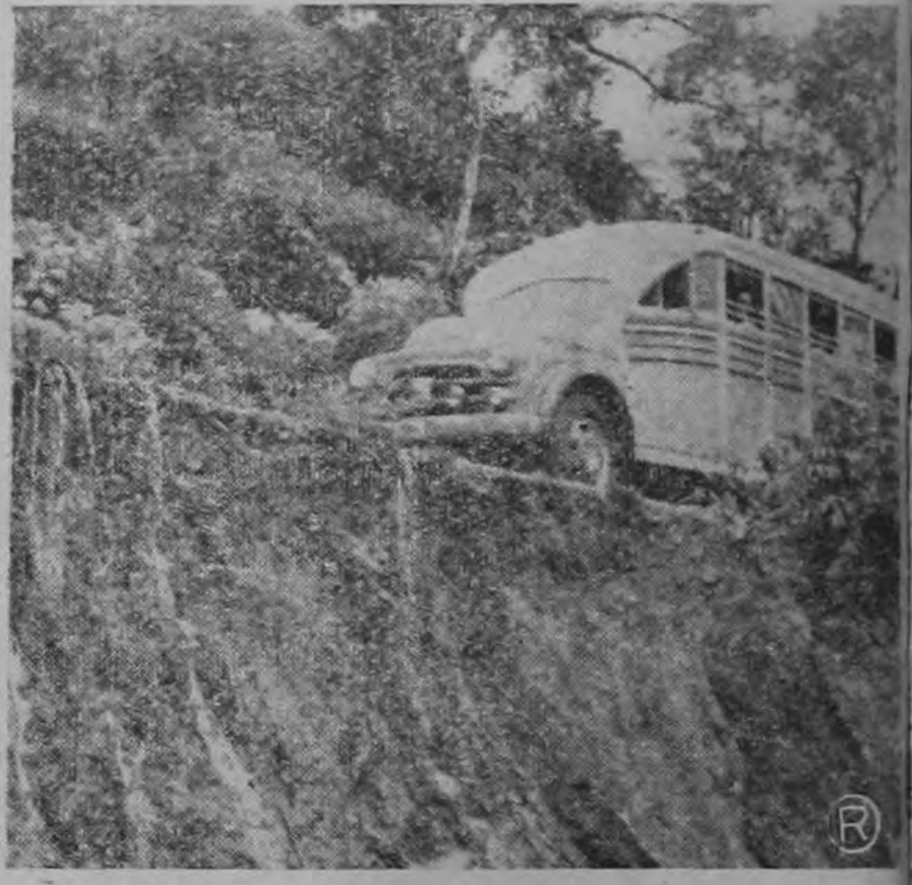
CARRETERA EN PELIGRO. — Los autobuses que se dirigen a Puntarenas corren peligro de un hundimiento, ya que la carretera se está desprendiendo. Véase la pequeña franja por donde circulan los vehículos. (Foto Claudio Cruz)
