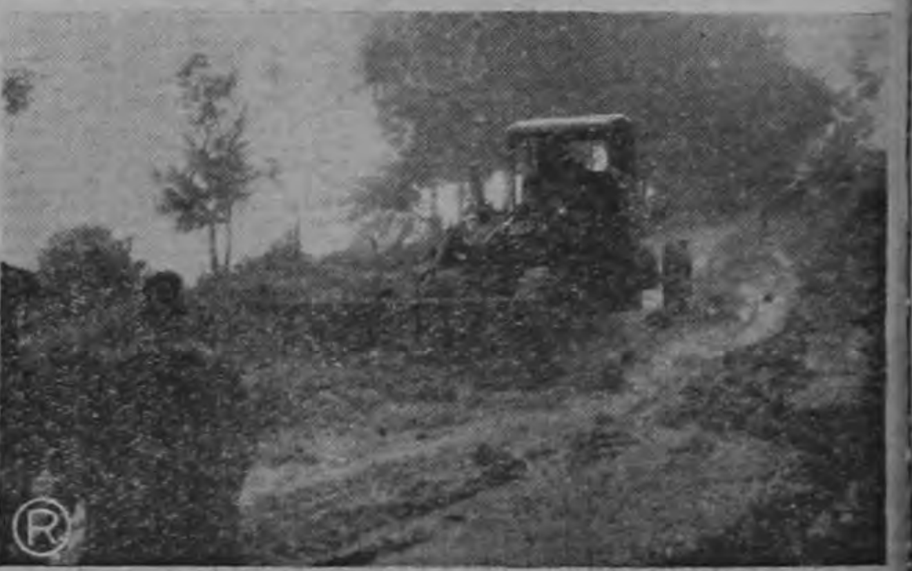
TRABAJOS EN TARBACA. — La gráfica muestra los momentos en que la maquinaria del Ministerio de Obras Públicas era empleada en el arreglo de la carretera a Tarbaca que había quedado intransitable debido a los temporales y derrumbes.
