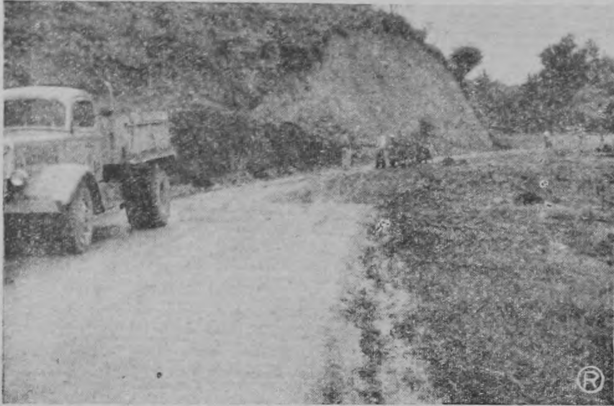
LIMPIANDO LA CARRETERA. — Gracias a la prontitud con que trabajaron cuadrillas y maquinaria de Obras Públicas, en pocas horas se logró limpiar la carretera a Cartago, sobre la que cayó un derrumbe de grandes proporciones que detuvo el tránsito de vehículos. Puede verse aquí cuando se concluía la labor de limpieza.
